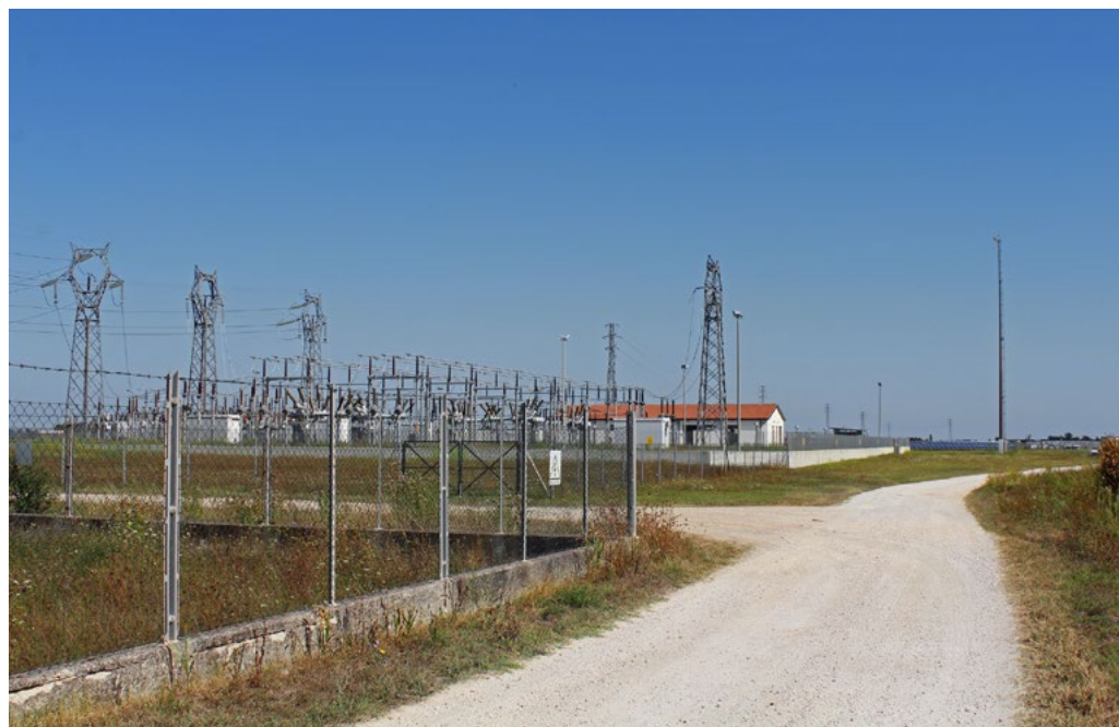
Fig. 2. Un cantiere 'abbandonato' di una centralina a ridosso del parco nazionale delle Dolomiti Bellunesi (BL), progetto bloccato grazie alla mobilitazione di diversi comitati locali e di una lunga battaglia legale (foto di Fabrizio D'Angelo, 2022).
