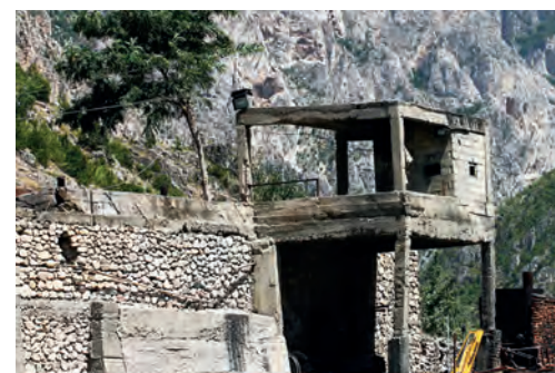
Strutture fatiscenti in prossimità dell'autostrada. Foto di Thomas Malaguti
